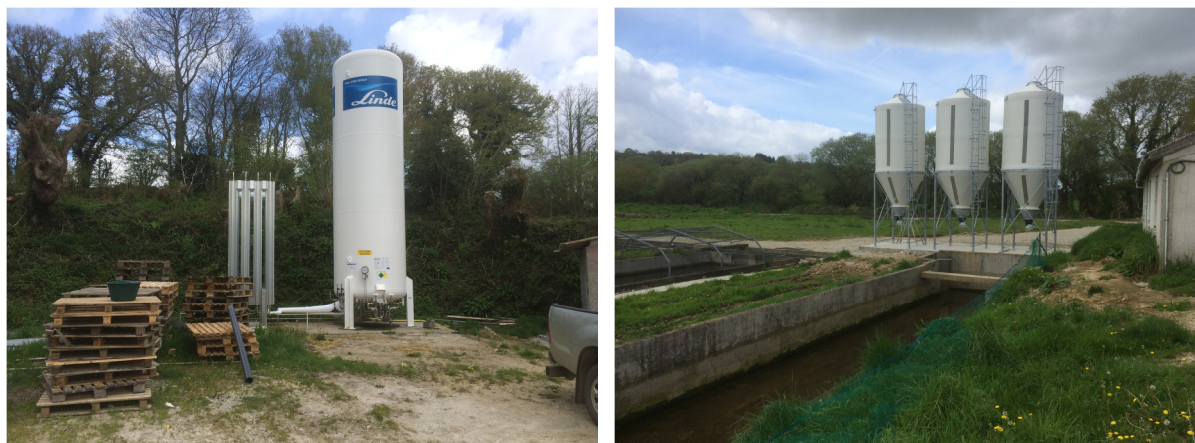
Figure 1-8 : Cuve de stockage (10 000L) de l'oxygène liquide – Silos de stockage de l'aliment (3 x15T)
